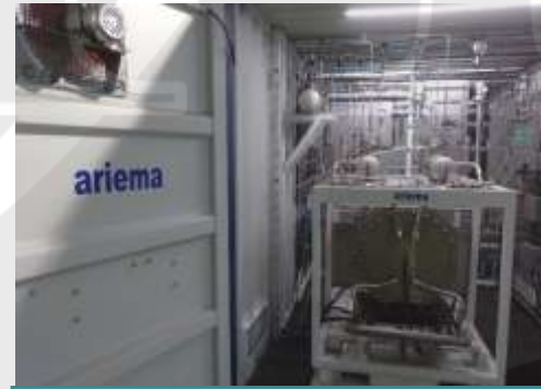
Electrolizador containerizado. Proyecto Aurora (Sacyr), 2017
